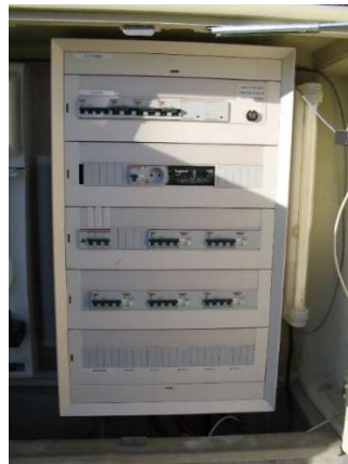
Vue d'un tableau de commande 5 départs
